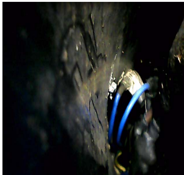
Slika 4b. Ilegalni odvojak na priključnom pod. kabelu
