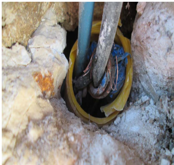
Slika 4a. Ilegalni odvojak na glavnom vodu
