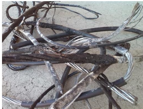
Slika 10. Utjecaj gnijezda na izoliranu zračnu NN mrežu (bez nosača za gnijezdo); oštećeni vodiči
