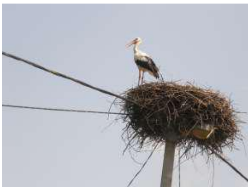
Slika 1. Rodino gnijezdo na stupu niskonaponske električne mreže
