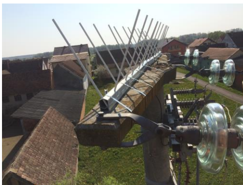
Slika 5. Ugrađeni izolacijski šiljci na rasteretnom stupu zračnog 10 kV dalekovoda u Donjoj Bebrini
