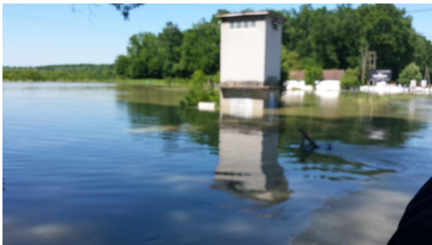
Slika 4. Transformatorska stanica 10/0,4 kV zahvaćena poplavom
