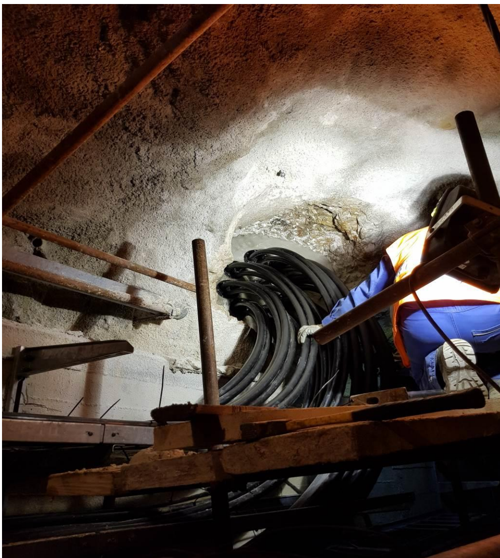
Slika 5. Izvedba izlaza kablskih veza iz tunela HE Rijeka s kablskim brtvenim uvodnicama
