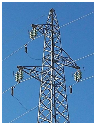
Slika 2. Prikaz postavljenih odvodnika na nosnom stupu
