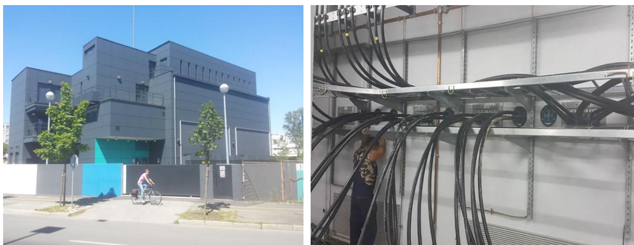
Slika 7. TS 110/10(20) kV Ferenščica
