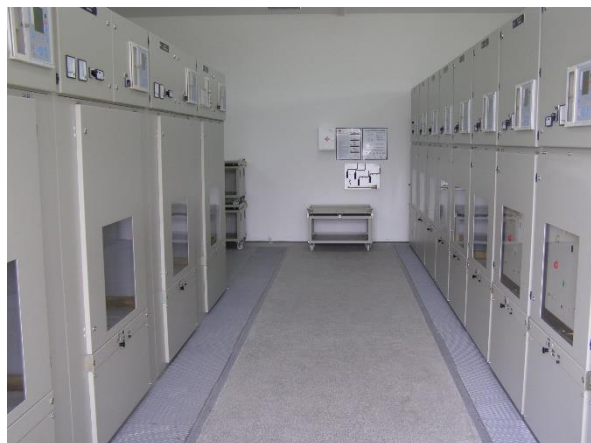
Primarno zrakom izolirano postrojenje
