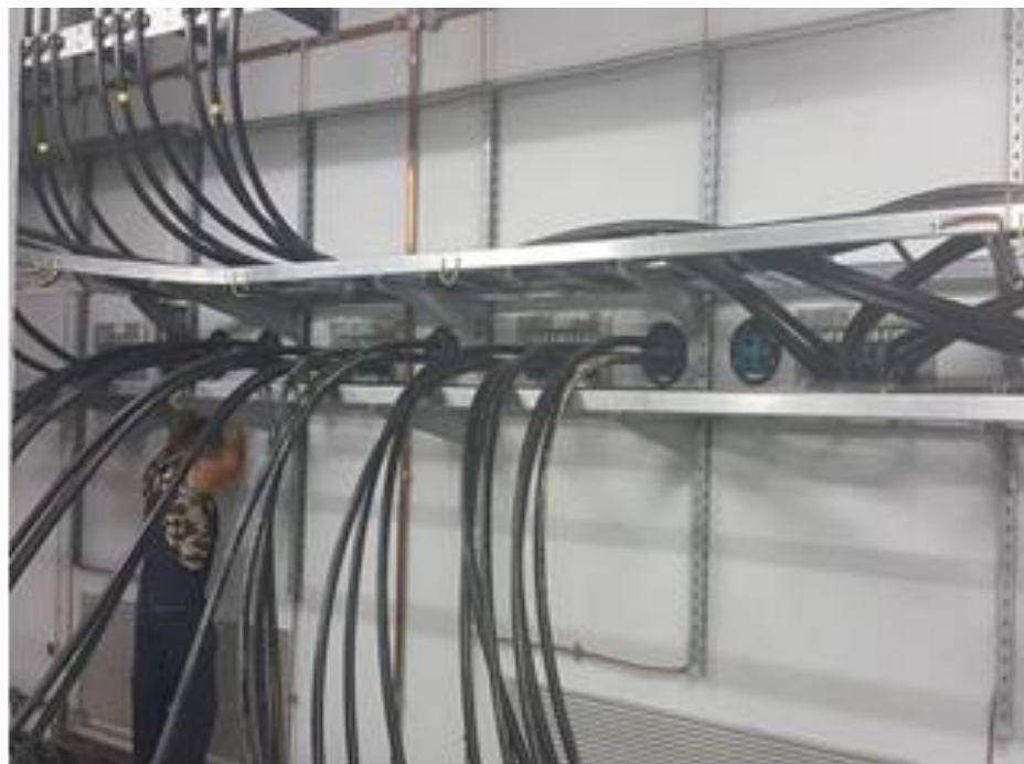
TS Ferenščica 110/10(20) kV
